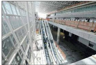
Terminal do aeroporto: Escadas rolantes estão funcionando
