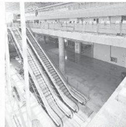
Escadas rolantes do novo terminal já foram testadas
