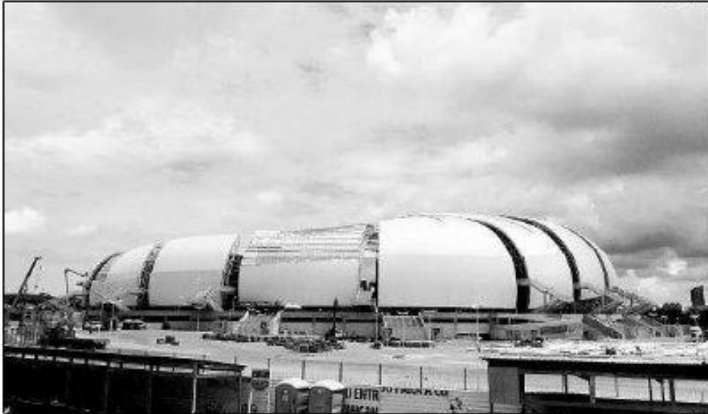
Arena das Dunas entra em fase final de acabamento para abrir as portas definitivamente ao público
