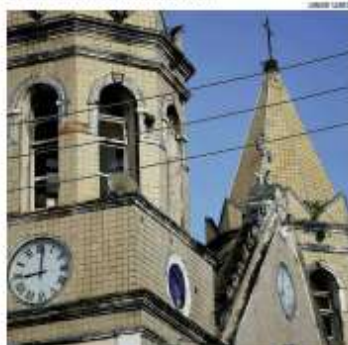
EM ANÁLISE Estudos técnicos vão avaliar a estrutura, a fundação e as condições do solo da Paróquia São Jerônimo das Dores, na Ribeira. Laudo apontou problemas nas lajes, na fachada e na área externa. - ver mais
