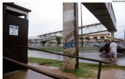
PASSARELAS O PNV deu 15 dias para que Drel e STB atualizem informações sobre passarelas existentes no RN-90, na Grande Natal. O órgão aponta riscos estruturais graves em situações acompanhadas desde 2011. » PÁGINA 9
