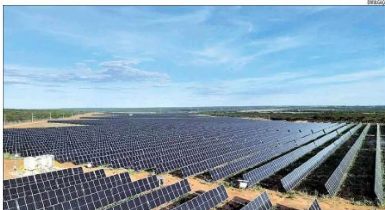
Grande parte do avanço recente no RN está associada ao Complexo Fotovoltaico Assú Sol, da Engie, instalado na cidade de Assú
