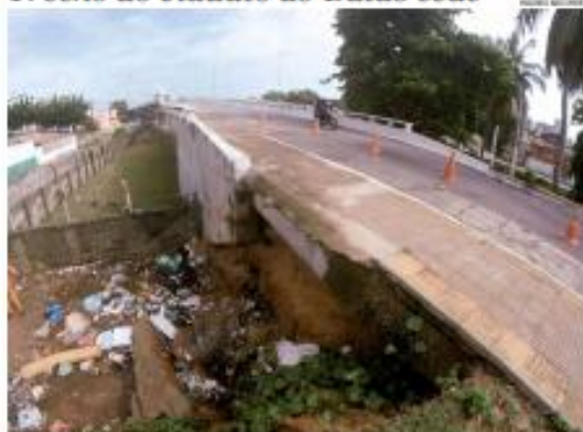
» REVE - A Secretaria de Infraestrutura de Natal inicia hoje (9) o reparo em trecho do viaduto do Baldo, na zona leste, que cedeu após fortes chuvas no final de semana. Parte da via está interditada. » PÁGINA 14 »
