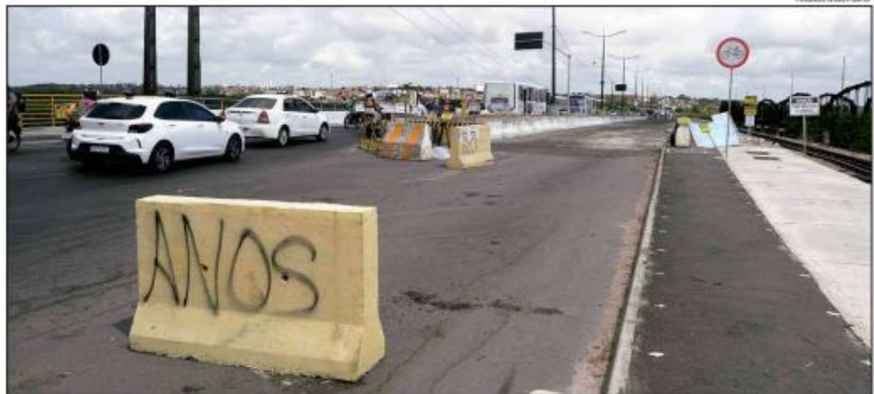
As obras de recuperação da Ponte de Igapó estão acontecendo desde 12 de setembro de 2023 e têm um orçamento de cerca de R$ 20,8 milhões
