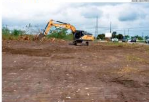
«PILICÓRIA» A Prefeitura de Parnamirim iniciou a duplicação do trecho da BR-311, mais conhecida como Estrada de Pium. Previsto é de que as obras sejam concluídas até novembro. » PÁGINA 8 «
