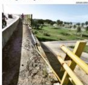
« ALERTA » Um baraco de quase 2 metros na estrutura metálica da Ponte Newton Navarro tem assustado pedestres e colocado em perigo quem utiliza o equipamento. « PÁGINA 12 »
