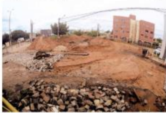
« TRANSPORTES » Motoristas e moradores reclamam de trecho esburacado na Avenida Ayrton Senna, em Nidópolis. Segundo a Secretaria de Infraestrutura, reparos vão levar mais 20 dias. «PÁGINA 6»
