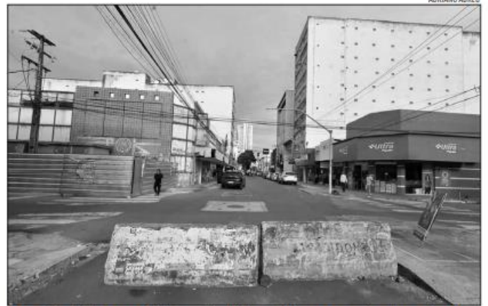
A nova etapa da obra na rua João Pessoa tem início previsto para a segunda quinzena de abril
