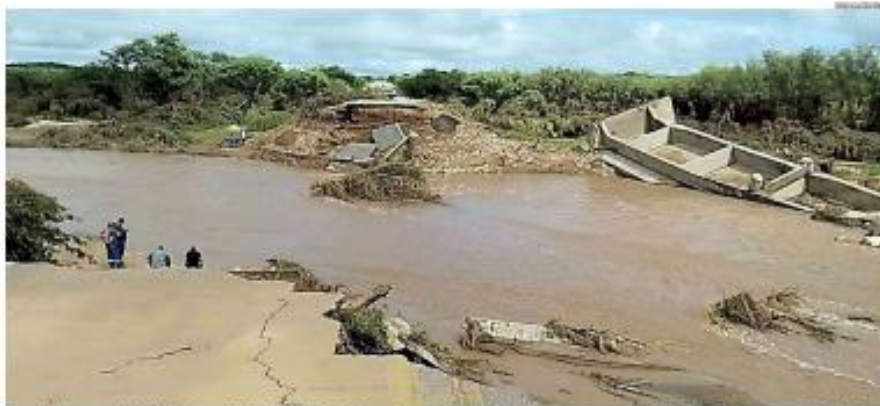
Chuvas deixaram cenário de destruição na BR-304. Ministério dos Transportes garante a construção de uma nova ponte e a abertura de um desvio na própria rodovia
