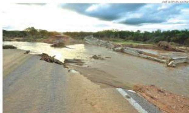
Trecho da BR-304 em Lajes, na região Central, foi interditado no domingo após ponte ser destruída pelo rompimento
