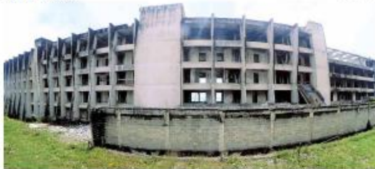
► REINAT ► O prazo para demolição do andar acidentado do antigo Hotel BBA, localizado na Via Costeira, se encerra no próximo dia 11 março. Mas, até agora, a retirada do pavimento tem ocorrido lentamente, apesar do trabalho permanente no local. ► PÁGINA 7
