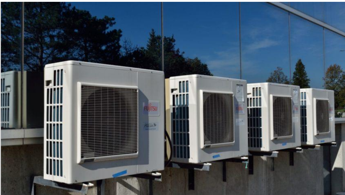
Na foto, 4 aparelhos de ar-condicionados um ao lado do outro
