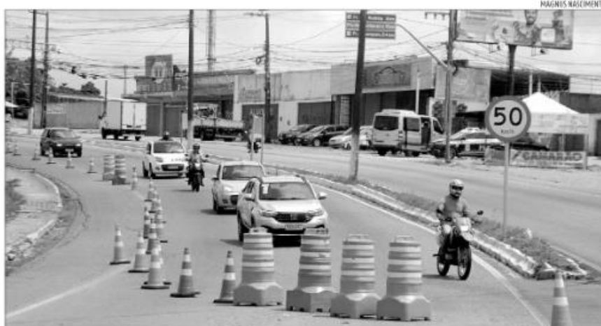
Segundo o Dnit, interdições na Ponte de Igapó devem durar cerca de 18 meses. Obras vão reforçar a estrutura da ponte
