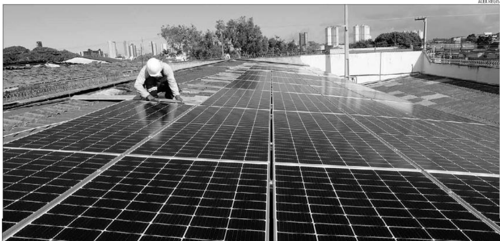
Este ano, até o início de novembro, segundo dados da Absolar, a energia solar cresceu 59,4%, com a potência instalada saltando de 13,8 gigawatts para 22 gigawatts
