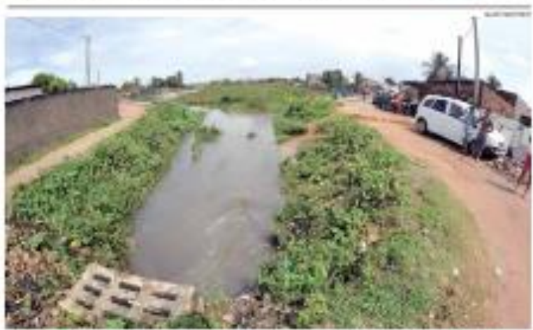
» FLOODING - Inundação no lançamento das obras na comunidade de São João, em Natal, para a obra de saneamento básico. » Mais...
