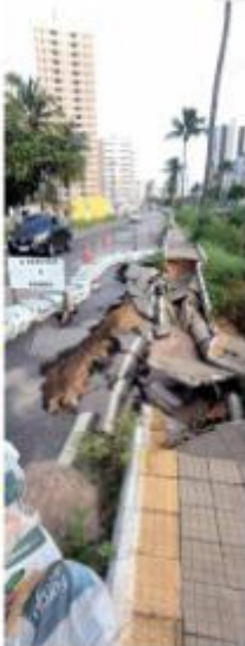
► DANOS O dano causado pela chuva em alguns dias, além de danos às estruturas de concreto e metal, causou o colapso de uma estrutura de concreto. ► DANOS
