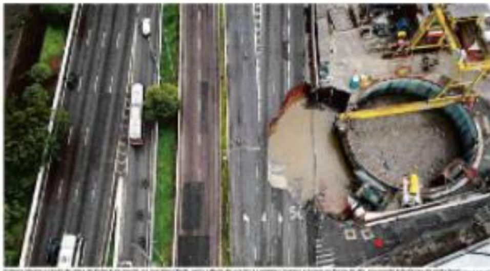
Uma obra de metrô do lado da Estação do metrô, na rua para Tupy, após o colapso de um pilar e o rompimento de uma das vigas de aço. O acidente é o maior da história da obra
